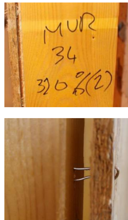
Figure 5 : Mode d'endommagement du mur après répliques du séisme à 1g
