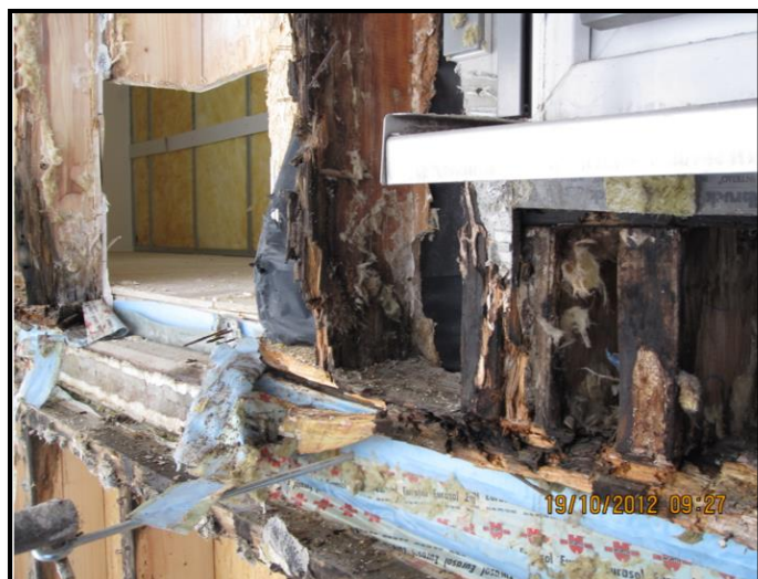
Photo 2 : Exemple de façade endommagée
