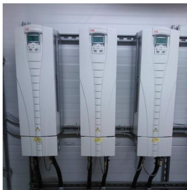
Photo 2 : Régulateurs indépendants pour chacun des trois ventilateurs du séchoir (Photo : ECOINFLOW)
