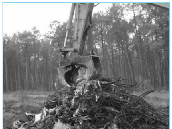
Photo 1 : En Aquitaine, les souches de pin maritime représentent un gisement de biomasse important, inexploité actuellement, qui peut être valorisé en énergie. Chantier expérimental d'extraction et de fragmentation à la cisaille sur pelle mécanique.
