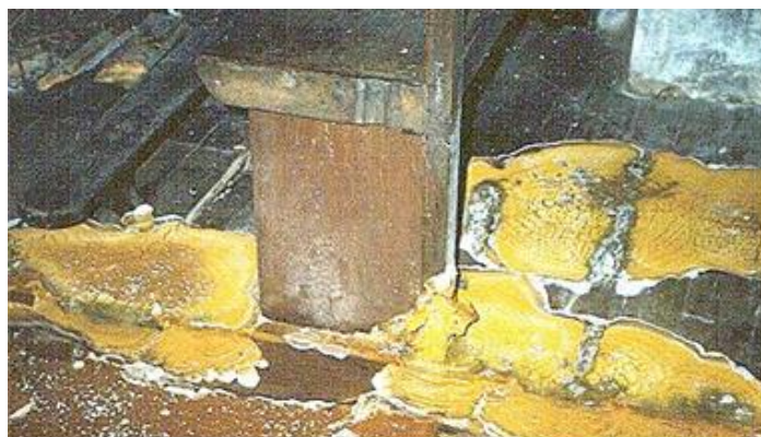
Photo 1 : Exemple de dégât de pourriture
